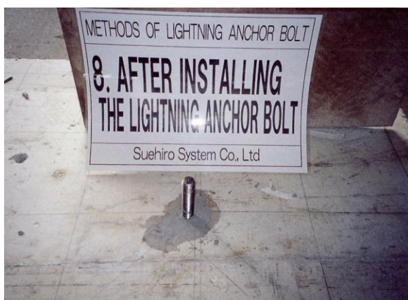
<イナズマアンカーボルト取付>
