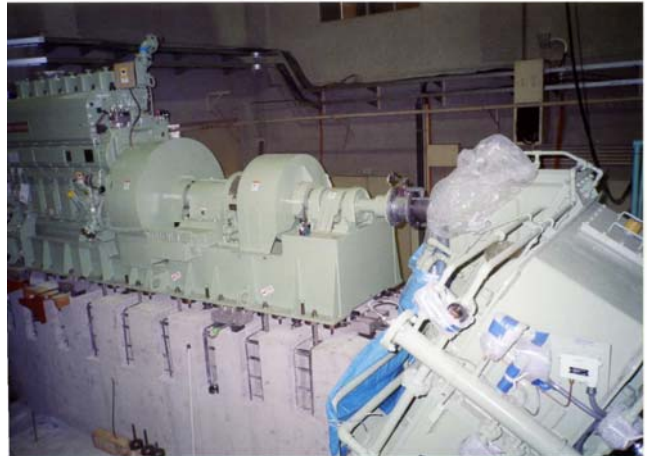
200ps エンジンと減速機の調整状況 (芯出し所要時間を50%に低減)
